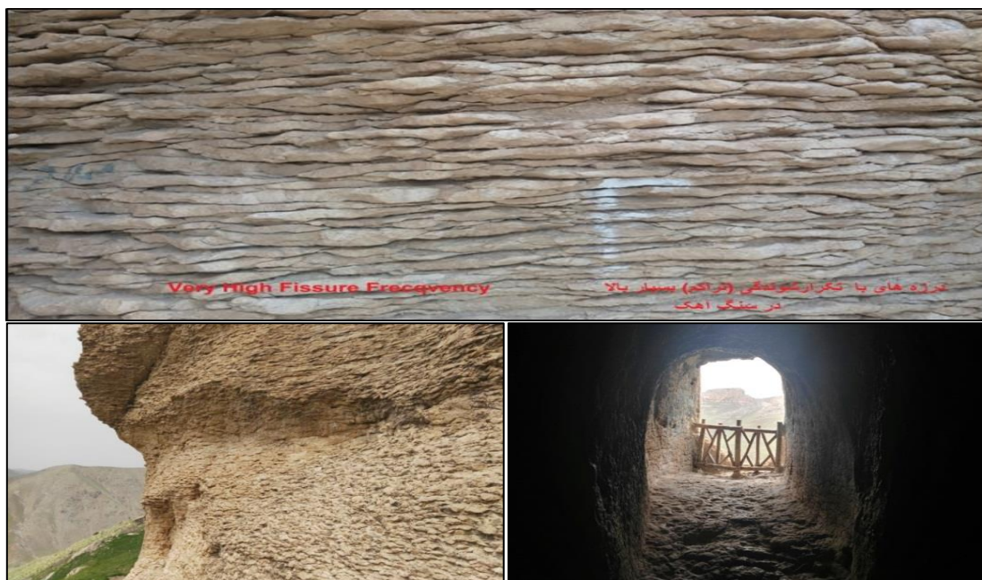
شکل ۸. شبکه درزه‌های بسیار متراکم ناشی از گسلش واحد آهکی f در دیواره بیرونی و داخل غار منبع: یافته‌های پژوهش، ۱۴۰۳
